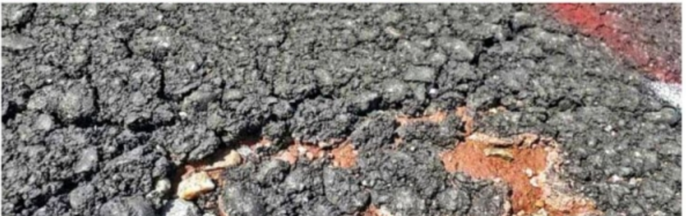
Baru selesai dikerjakan, Aspal nampak retak di Luwu Timur
